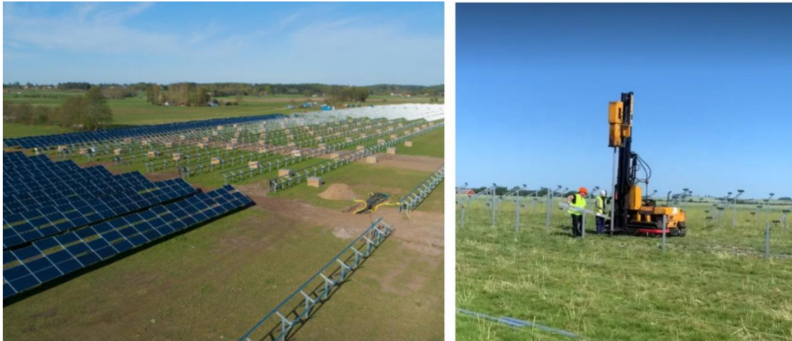
Figur 4.2. Vänster: exempel på montage av solpaneler på markställningar. Anläggningen är Svea Solars solenergianläggning i Sjöbo (Bildkälla: Ny Teknik). Höger: Pålning av balkar med pålningsmaskin (foto: Magnus Fast, OX2).
