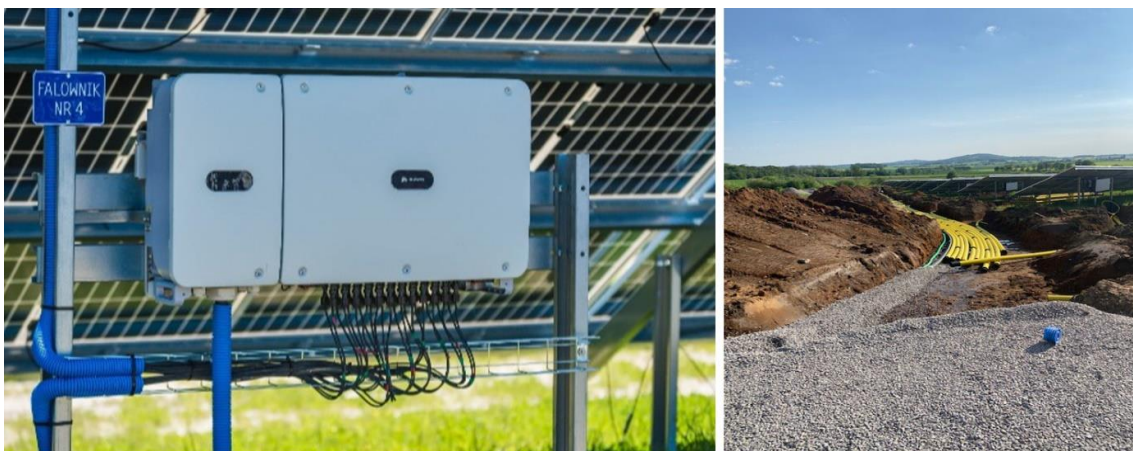
Figur 4.3. Vänster: växelriktare som monterats på markställning (bildkälla: www.ske-solar.com). Höger: exempel på kabelschakt inom anläggningen (foto: Magnus Fast, OX2).
