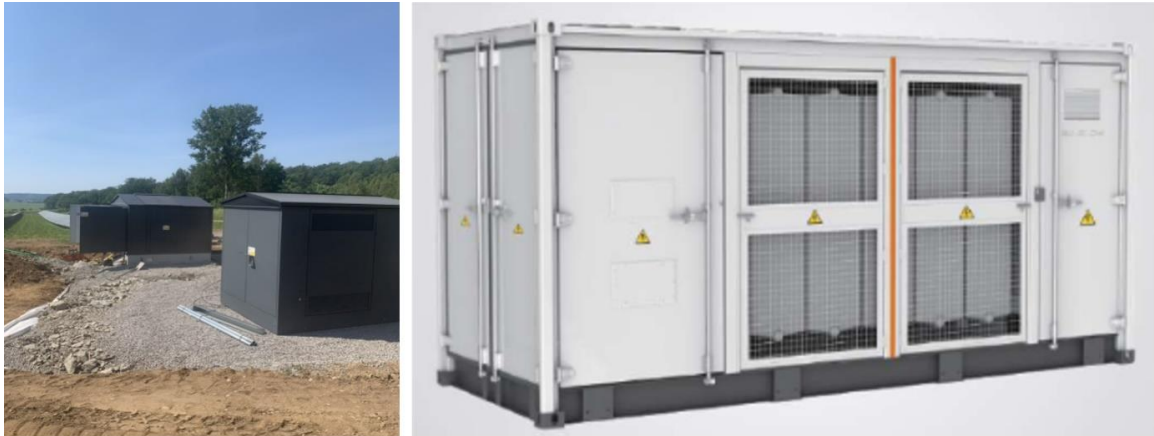
Figur 4.4. Vänster: exempel på utformning av transformatorstation inom anläggningen (foto: Magnus Fast OX2). Höger: exempel på utformning av uppsamlingsstation inom anläggningen (foto: OX2).
